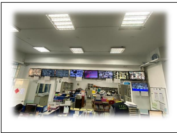
◆ (圖 2-4) 建置校園監視系統杜絕校園死角
